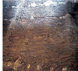
Stahlsiebbelag zeigt 100% Anbackung
